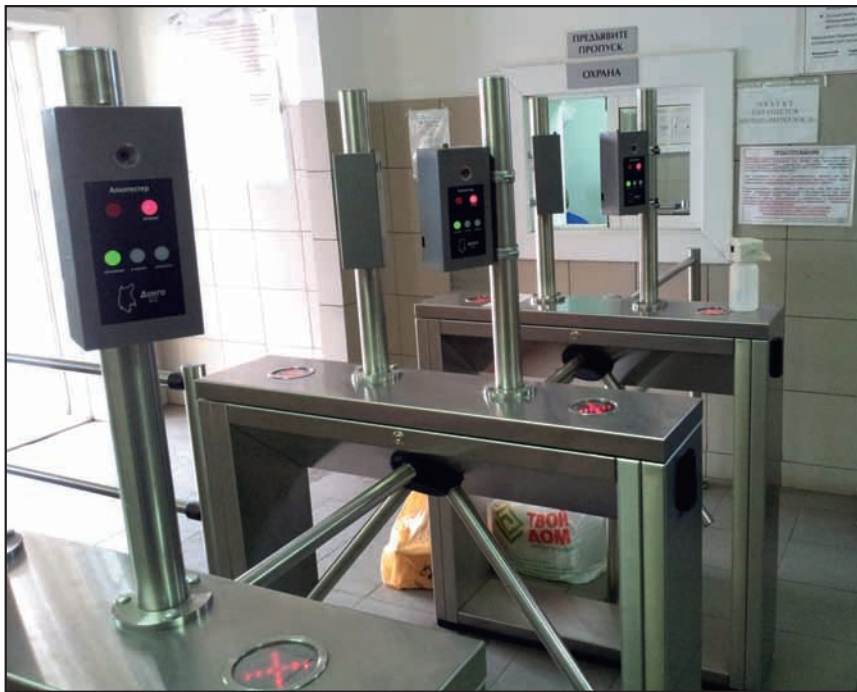
Рис. 3. Проходная, оснащенная средствами тестирования на алкоголь. Проход разрешается только после получения подтверждающего сигнала от алкотестера
